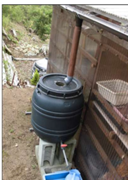
1号機 (屋根から集水)
