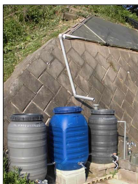
2号機 (斜面から集水)
