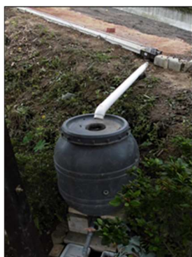
3号機 (道路から集水)
